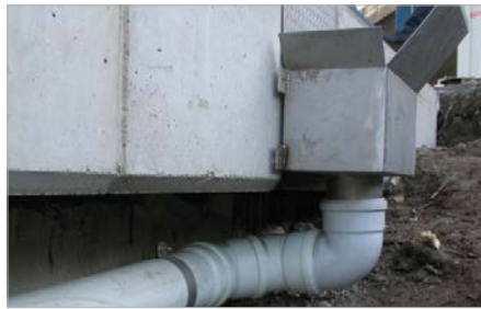
Üblicher FÜK-Einlauf aus Edelstahl (Korrosionsproblem!)
